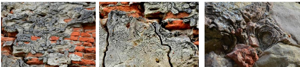
20-22. kép A „Liesegang-mintázat” külső homlokzaton, téglafalra felvitt középkori mészhabarcs szerkezetében. Jakabfalva, Erdély, Románia.
