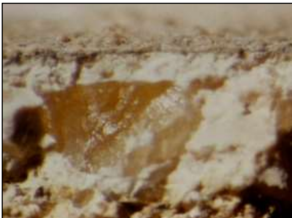
73. kép. Kalcit szemcsé az intonacóban . (K/Sz-Vt I/1. mennyezet. Restaurálási dokumentáció. Foto: H.E.-K.Zs.)
