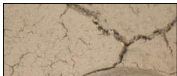
17/e. kép. Az épített szerkezet felületét kiegyenlítő, elsőként felhordott vakolatrétegből származó minta savban nem oldódó maradéka. Sztereo-mikroszkópos felvétel (Foto: H.E.)
